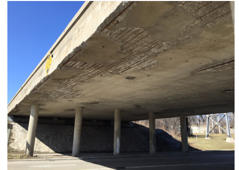
Deterioro de las condiciones del puente
